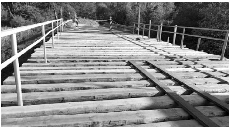
Naujai pakloti rąstai vietinių gyventojų per daug nedžiugina – žmonės baiminasi dėl to, kad metalinės sijos liko nepakeistos, tad rąstai eismą atlaikys galbūt tik dešimtmetį. „Anykšta“ atsakymo dėl remonto darbų iš „Via Lietuva“ negavo.
